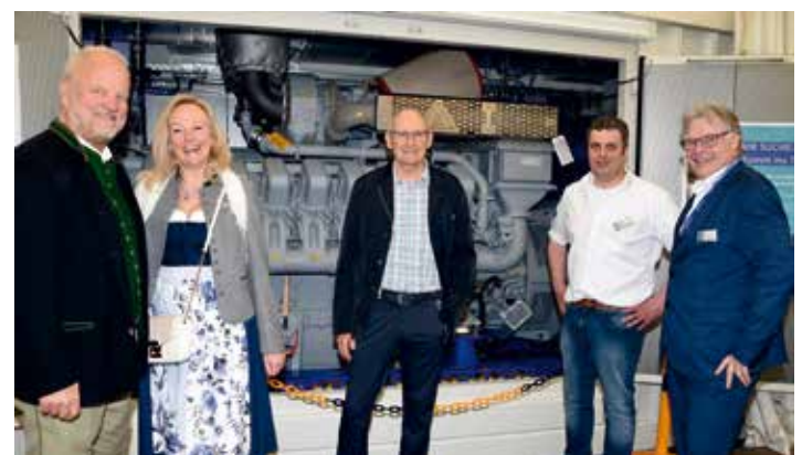
Mit 3200 Pferdestärken Gesamtleistung“ sorgt das bärenstarke Dieselaggregat von Rolls Royce/MTU beispielsweise auch in Silicon Valley (Kalifornien) bei Stromausfällen für gesicherte „Cloud-Daten“ von Computer-Weltkonzernen. Rechts Prokurist Robert Schweikl mit Service-Koordinator Christian Wagnerbauer.
